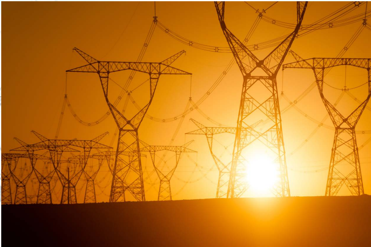
รูปที่ 4 เสาส่งไฟฟ้าแรงสูง
