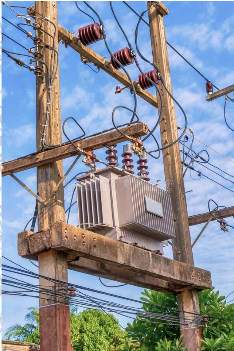
รูปที่ 5 หม้อแปลงไฟฟ้า
